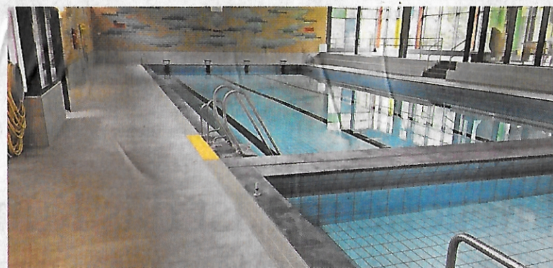
Ein Blick in die Schwimmhalle nach den Sanierungsarbeiten. Der Boden ist neu gefliest worden.
